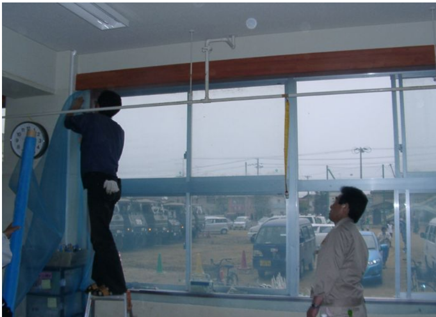
居住スペース設置例 (窓枠はめ込み式)
